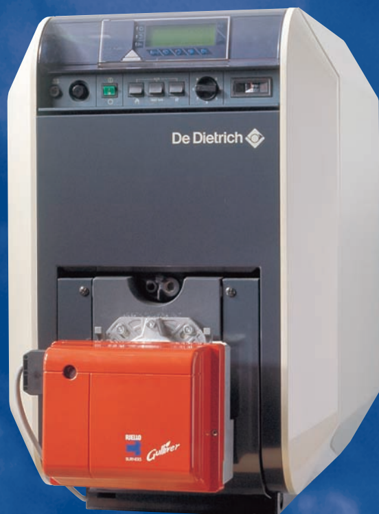
Her ses en De Dietrich støbejernskedel monteret med en Riello Gulliver oliebrænder type RG0.R
